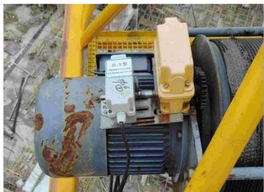
塔吊监控传感器
